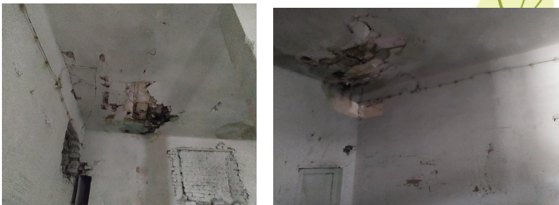
Foto 4. Starea actuală (tavane) a celor trei celule neamenajate din clădirea Siloz fructe
