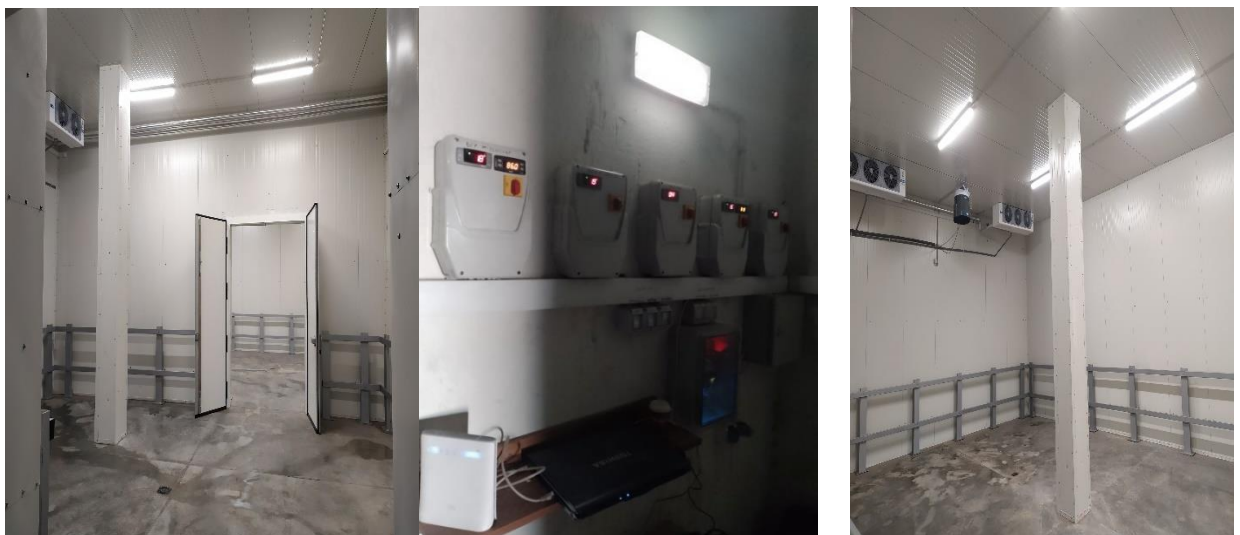
Figura 30. Aspecte din interiorul silozului de fructe - celule modernizate cu echipamentele de automatizare și control al sistemului de răcire și umidificare
